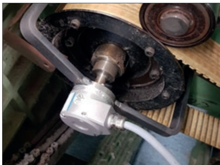
Exemple de codeur installé sur un métier à tisser
